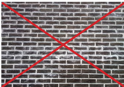
UNNGÅ kalkutfelling og hvite renner på teglveggen
