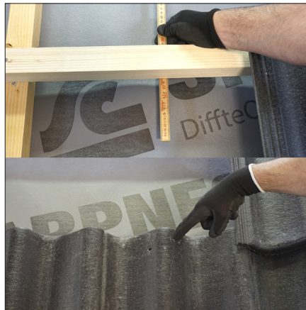
2. Marker målet fra topp lekke. Marker midt på takprofil.
