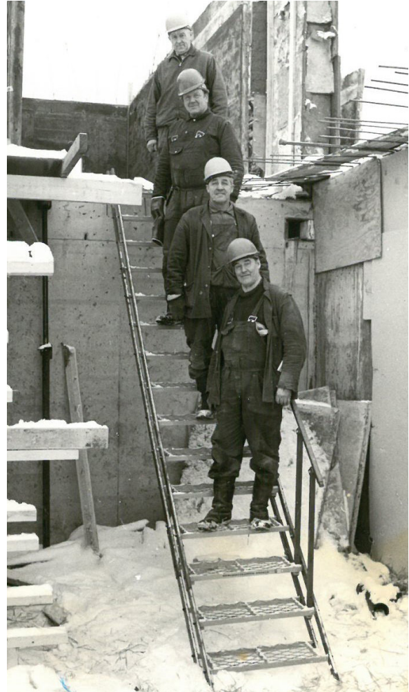
Bilden visar arbetare på den första 15 stegs trappan som användes vid byggnationen av sim- och sporthallen i trappans hemort Edsbyn.
