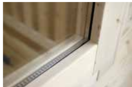
2-lags isolerglass i dører og vinduer
