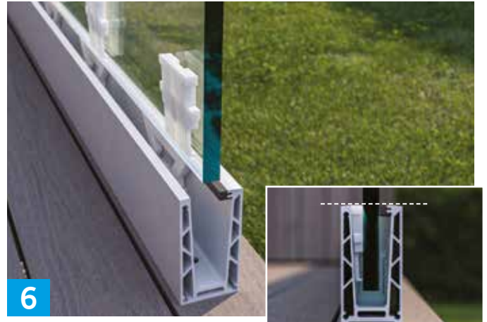
6 Plasser glassene i monterings skinnen med avstand 3-10 mm mellom hvert glass. Ved hjørner startes plassering som vist i bilde 7. Plasser låsekilene på innsiden av glasset som vist på det lille bildet. Topp låsekile skal flukte med topp skinne.
