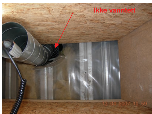
Fig. 5 b Ved åpning av et av friskluftinntakene ble det funnet at selv om en dampsperre var benyttet, var ikke løsningen vanntett. En gjennomføring perforerte dampsperran, slik at vann som kom inn gjennom inntaksristene kom videre inn i konstruksjonene og inn i bygningen. Foto: SINTEF Byggforsk
