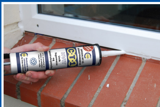
Tetter fuger umiddelbart
