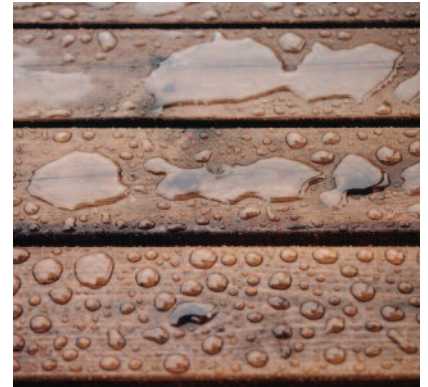
Nylig overflatebehandlet og utsatt for regn.
