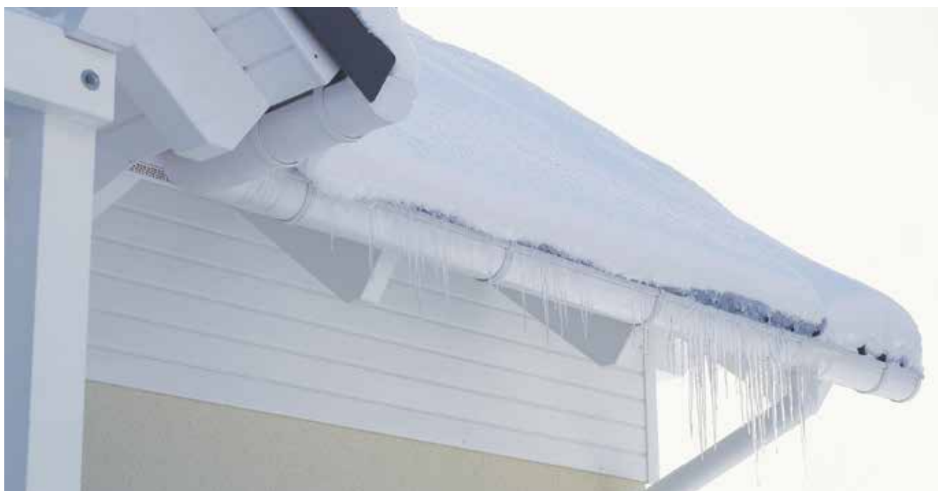
Istapper og issvuller er tegn på dårlig isolasjon og kan gi fuktproblemer i takkonstruksjonen
