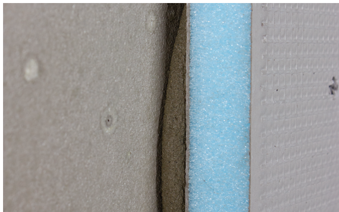
Fest platen på vegg og kontroller innretning.
