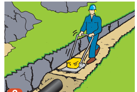
9 Gjenfylling opp til terrengnivå skal skje slik at man tilfredsstiller krav til bæreevne.
