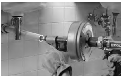
Figura 7 – Ejemplo de una extensión del desagüe para que la limpiadora quede a menos de 4 pulgadas (10 cm) de la apertura del desagüe
