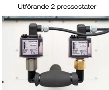
Max. pressostat 2 Min. pressostat 3
