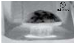
DÅRLIG BOLTFFESTE (DEN OVALE HALSEN PÅ BOLTEN SITTER IKKE RIKTIG I BOLTHULLET)
