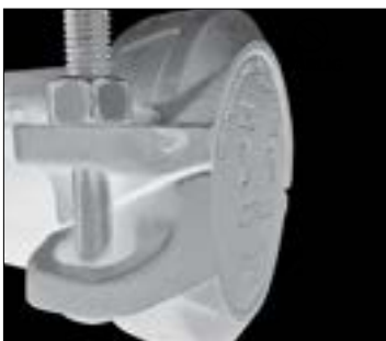
DÅRLIG MONTERING (BOLTENES KONTAKTFLATER HAR IKKE METALL-MOT-METALL-KONTAKT)
