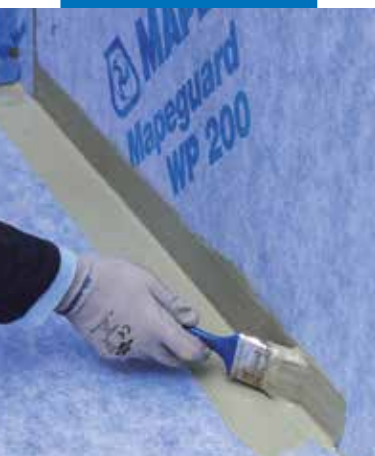
Påføring av Mapeguard WP Adhesive for å forsegle alle fuger i hjørnet for påføring av Mapeguard ST
