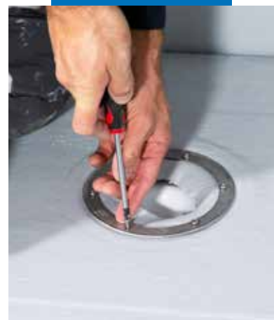
Butylmansjett (selvklebende) legges ned over sluk (på ferdig primet gulv). Deretter påføres Mapegum WPS over mansjett og resten av gulvet
