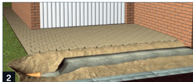
2 Hell betong i kanalen. Blandingsforhold: ca. 1/3 sement og 2/3 grus. Betongtykkelse min. 10 cm. Vær oppmerksom på utløpets plassering.
