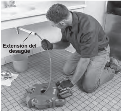
Figura 5 – Ejemplo de cómo extender el desagüe para que el acceso quede a menos de 3 pies (1 m) de la salida del cable
