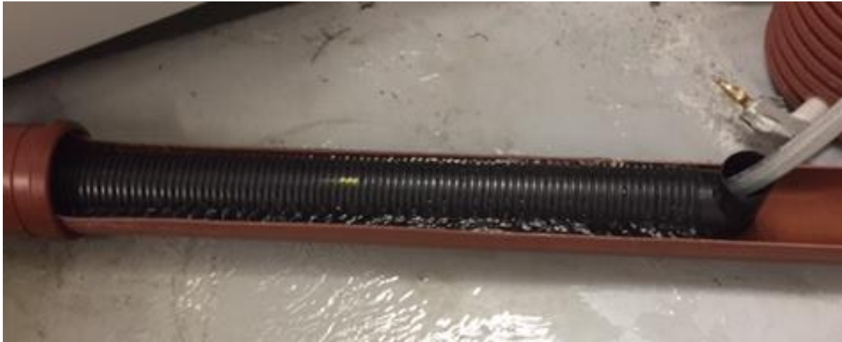
Måling av vannmengden som lekker ut av drenerør
