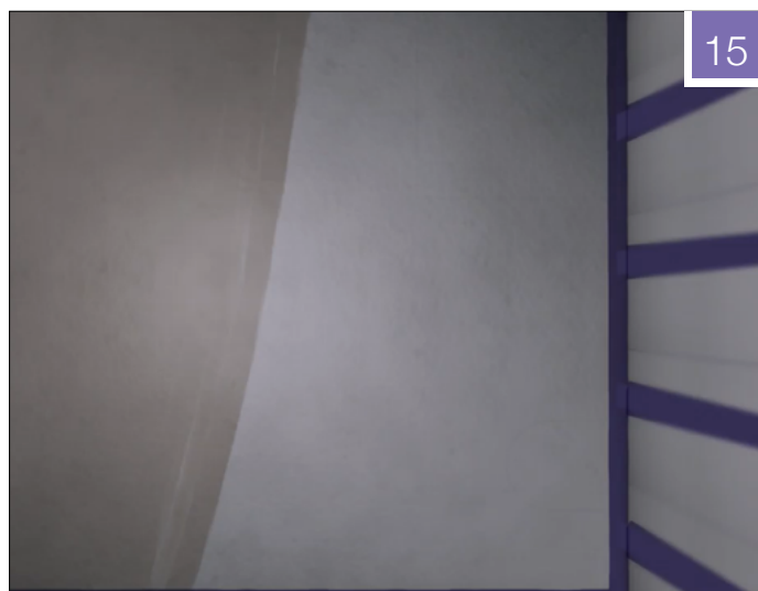
Fig. 15: Husk at hele gulvet regnes som våtsone. Gulvet og dets komponenter skal helsmøres med membran etter anvisning fra membranprodusenten.
