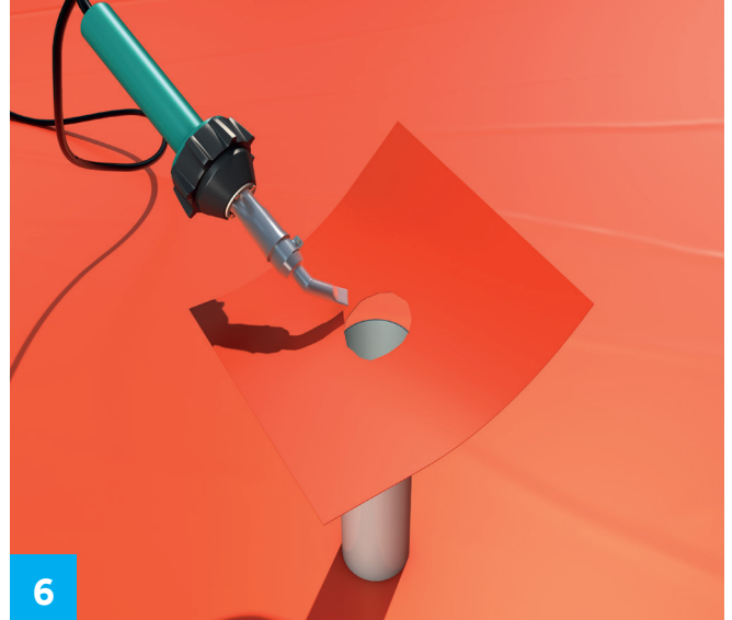
6 Varm godt rundt hullet og trekk lappen ned over røret, det skal dannes en oppkant på ca 15 mm rundt røret. Sveis fast lappen til membranen.
