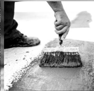
Til utblending av gysemasse/heftgrunning
